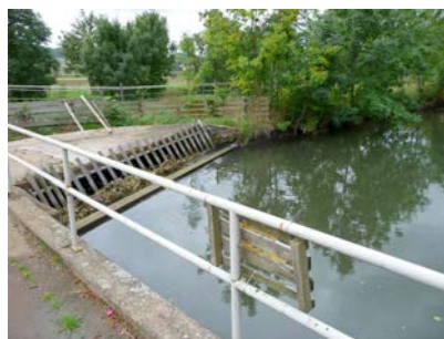
Grobrechen vor dem Überlauf zur Turbine
