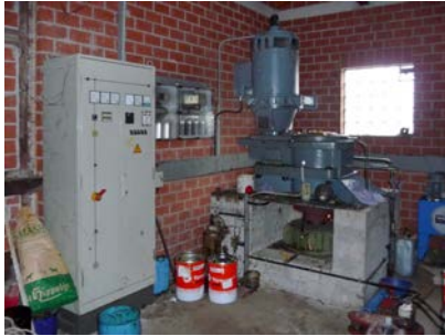
Turbine zur Stromerzeugung
